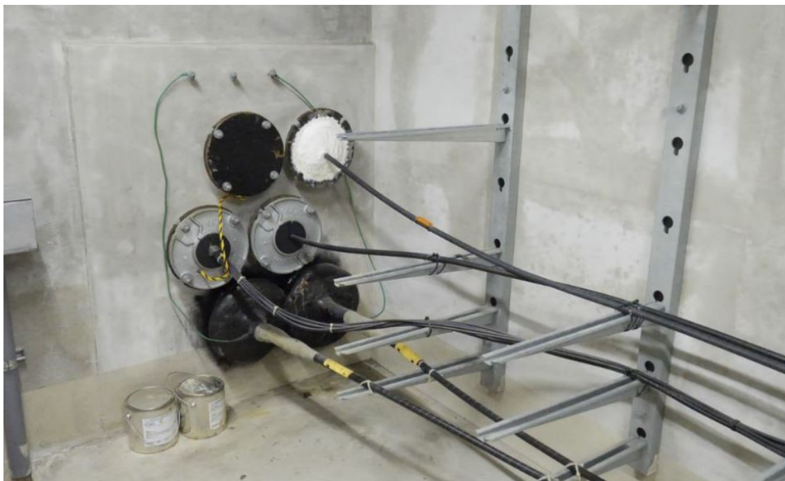
Figure 9 : exemple, vue intérieure d'une chambre d'atterrage
