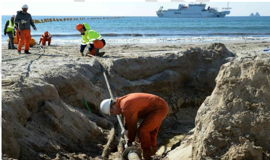
Figure 8 : exemple, passage du câble dans une conduite menant à la chambre d'atterrage
